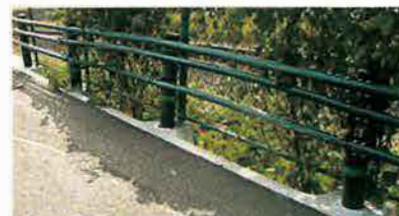
衝突した後の状況
