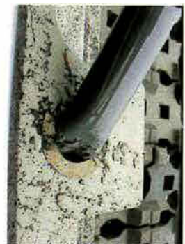
1本目のひび割れ状況
