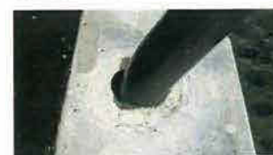
縦断方から見た支柱の変位状況
