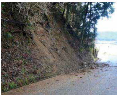
施工前：斜面崩壊
