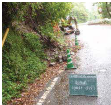
小規模崩壊の状況
