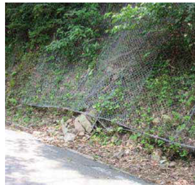
落石防護網裾のこぼれ出し状況
