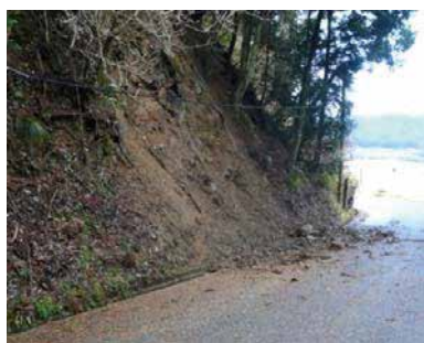
施工前：斜面崩壊
