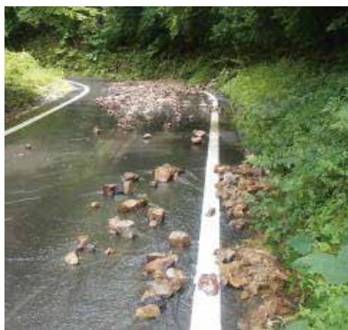
小規模落石の状況
