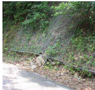
落石防護網裾のこぼれ出し状況
