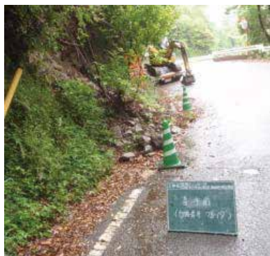
小規模崩壊の状況
