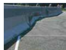
衝突地点から見た状況
