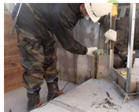
スレートボード位置を決定し、設置後に削孔(設置位置で組み立てた場合)
