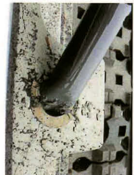
1本目のひび割れ状況
