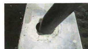
縦断方から見た支柱の変位状況
