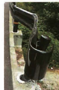
衝突後の状況
