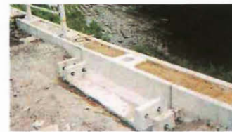
⑥製品を設置した状況
