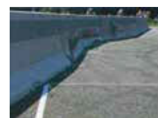
衝突地点から見た状況
